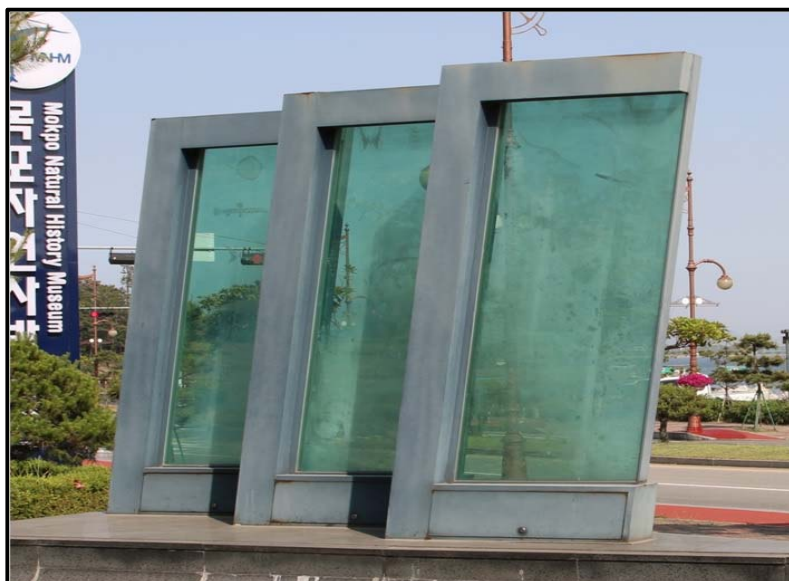
유리 접합면 지속적인 습기 발생 및 조명 시설 노후화
